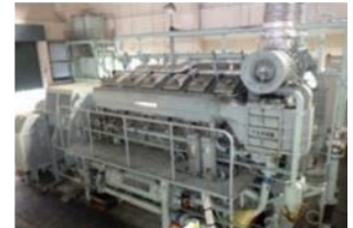
例：自家用発電機の整備
